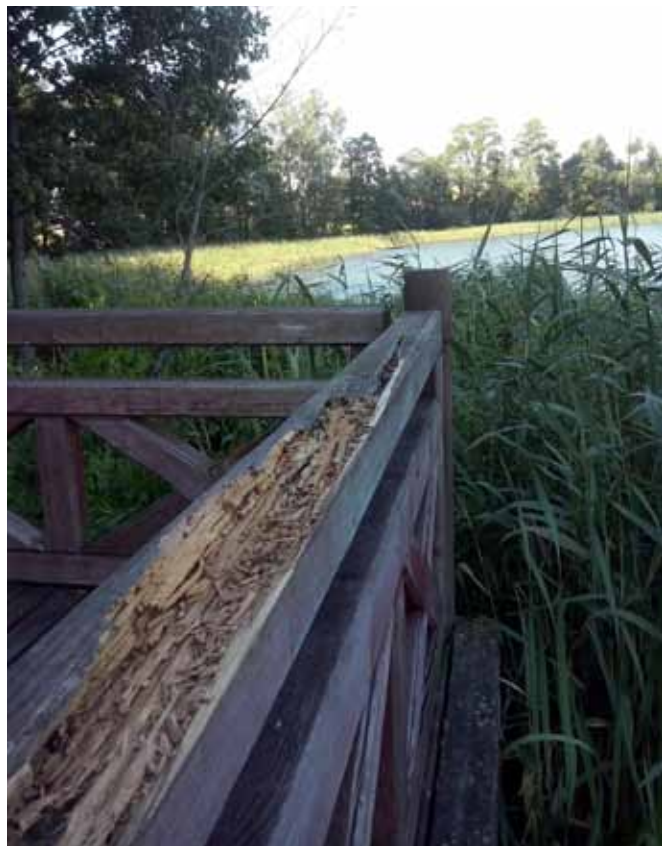
Rozsypana się barierka punktu widokowego na jezioro umiejscowione w Sedrankach
